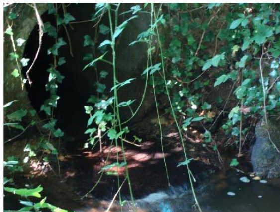
Buse Ø600 sous la route de la Lande Saint Fiacre
