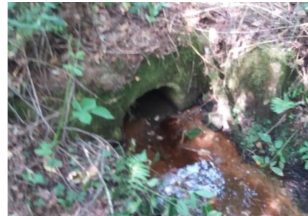
Photo 8 : OH-K-2 ( \varnothing 500) sous la RD 782
